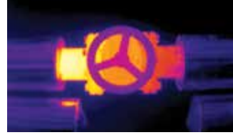
Yalıtımsız vananın termal kamera görüntüsü
